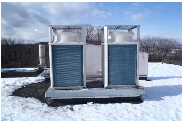
屋上空調屋外機
